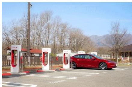
道の駅に設置されたスーパーチャージャー那須 (栃木県那須郡那須町高久乙 593-8)
